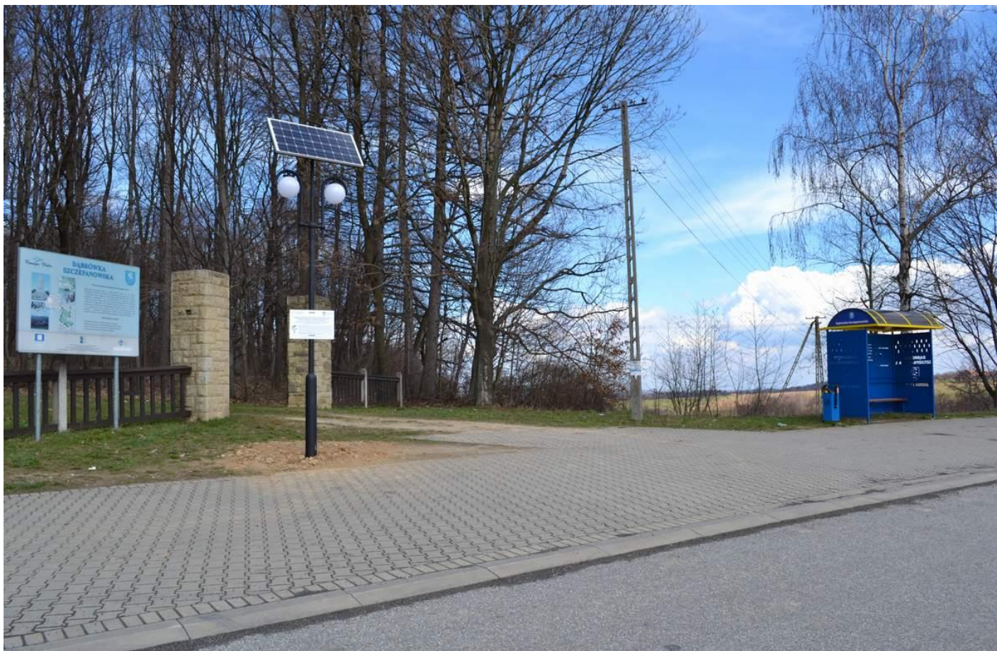
Po montażu lampy z panelami fotowoltaicznymi
